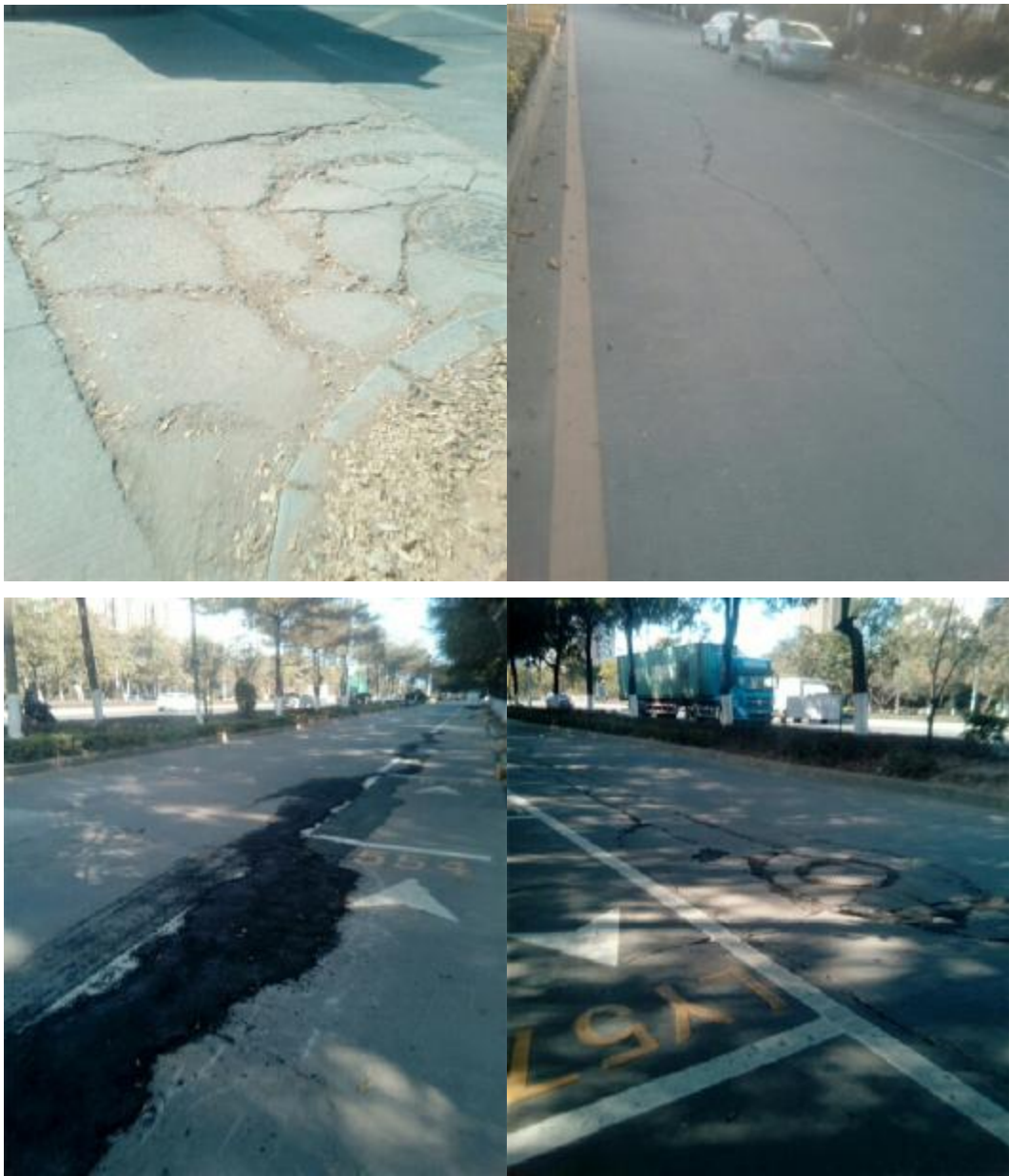
图 1-1 现状路面破坏情况
